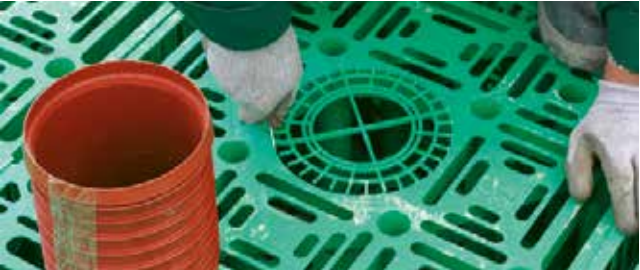
Vývod potrubí DN 200 mm
